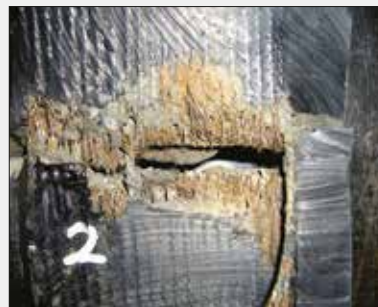
Stahlcordbruch durch Rost
