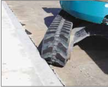
Mögliche Ursache für Kantenbrüche
