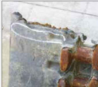
Stahlcordbruch am Ende des Überlappungsbereiches
