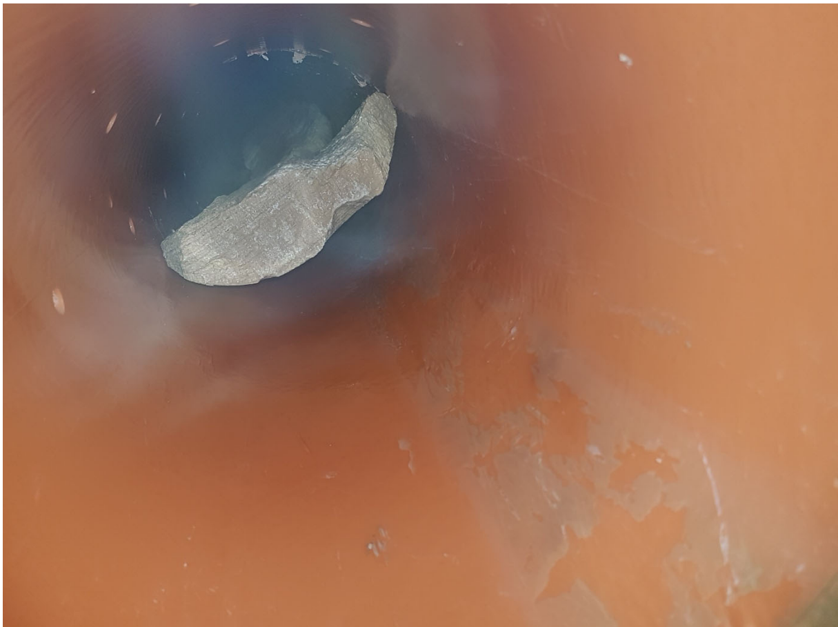
Beispiel eines angetroffenen Hindernisses in einer Entwässerungsleitung.
